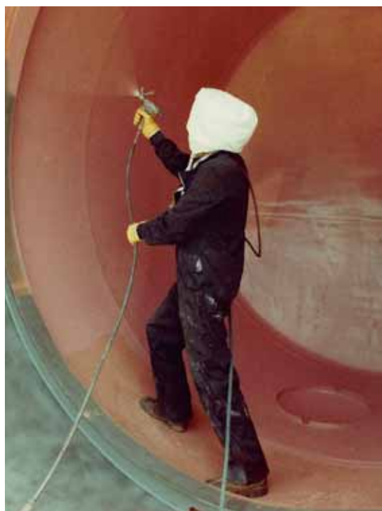
Fig. 6: le resine epossidiche sono una causa frequente di allergie cutanee. In caso di applicazione su una vasta superficie e soprattutto nei lavori di verniciatura a spruzzo, queste resine rilasciano vapori e aerosol che possono contaminare l'aria ambiente e scatenare un eczema. Per questo motivo è necessaria una protezione totale.
