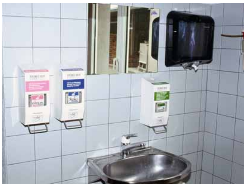
Figura 18: stazione di lavaggio in una fabbrica di cemento con dispenser di crema e sapone e regolazione della temperatura dell'acqua.
