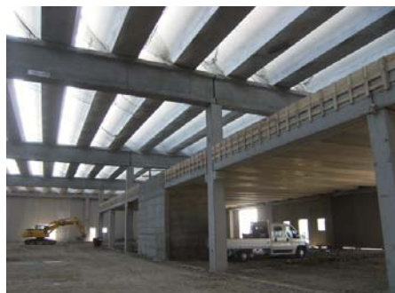
Figura 3 Esempio di utilizzo di un sistema S (coperture di grandi capannoni industriali)
